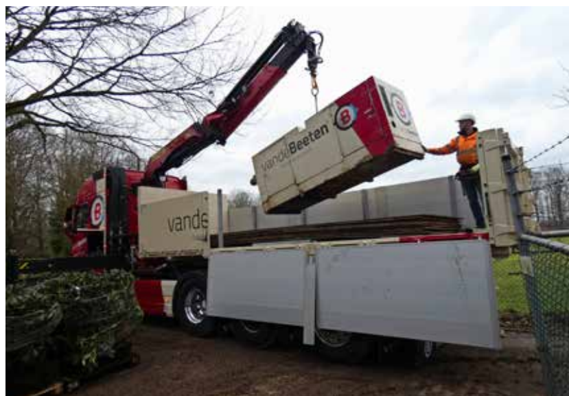
En de pomp is ook aan boord.
